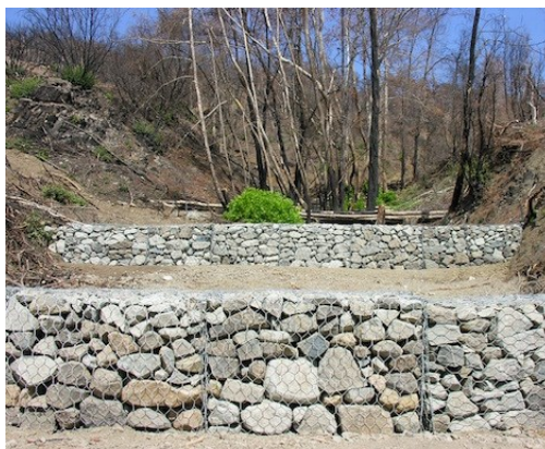
Περιοχές κοιτών που διαπλατύνθηκαν λόγω διάβρωσης
